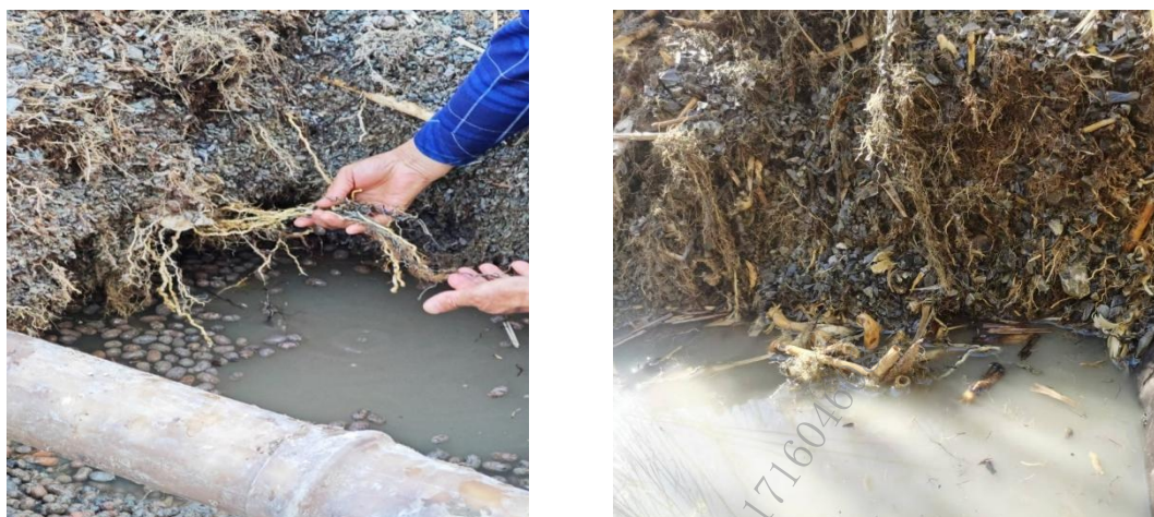
图 3.2-4 典型探坑地质情况（板结、根系堵塞）
