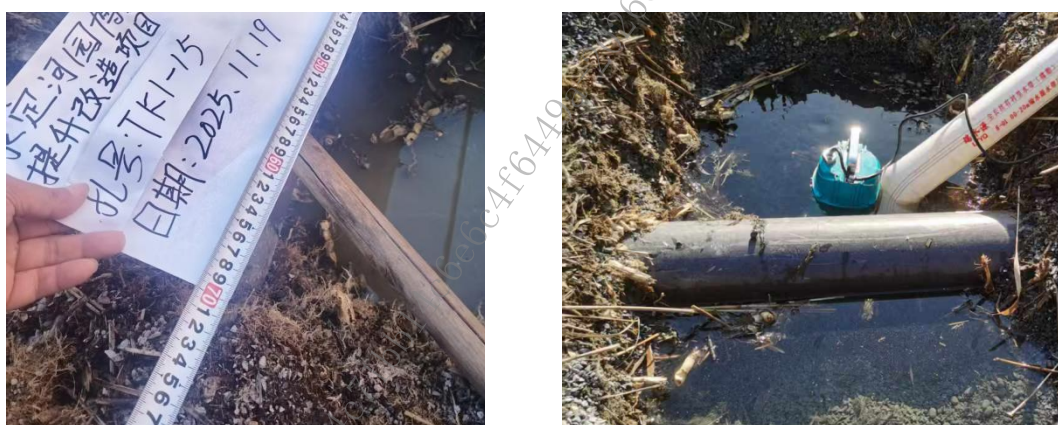
图 3.2-5 典型探坑水管情况（开裂、孔隙堵塞）
